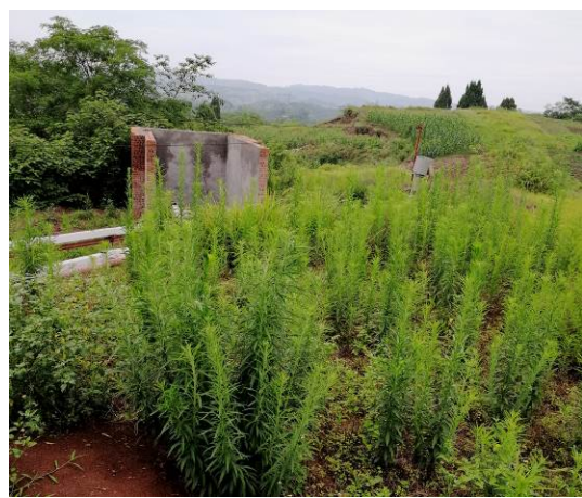
放喷坑 (挖损损毁程度: 重度)
