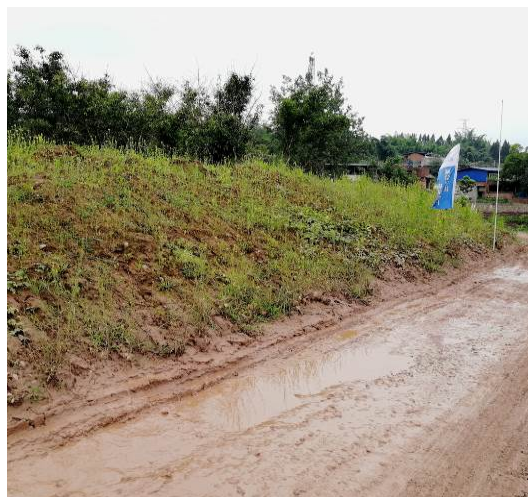
进场道路 (挖损损毁程度: 重度)
