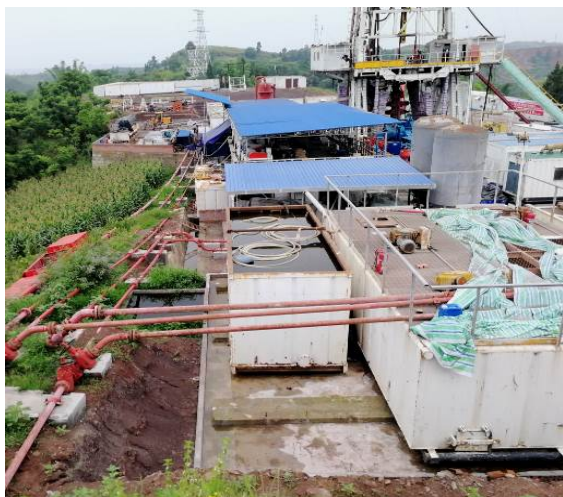
井场 (挖损损毁程度: 重度)
