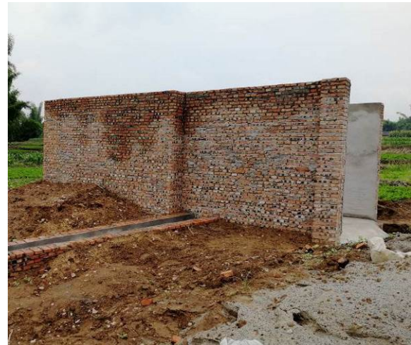
放喷坑 (挖损损毁程度: 重度)
