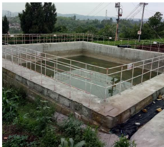
应急池 (挖损损毁程度: 重度)
