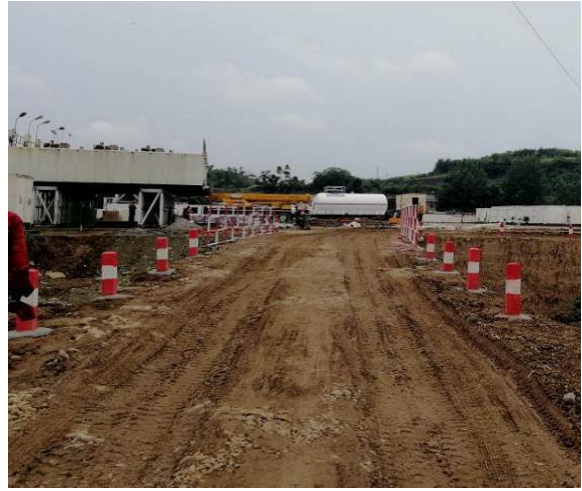
进场道路 (挖损损毁程度: 重度)
