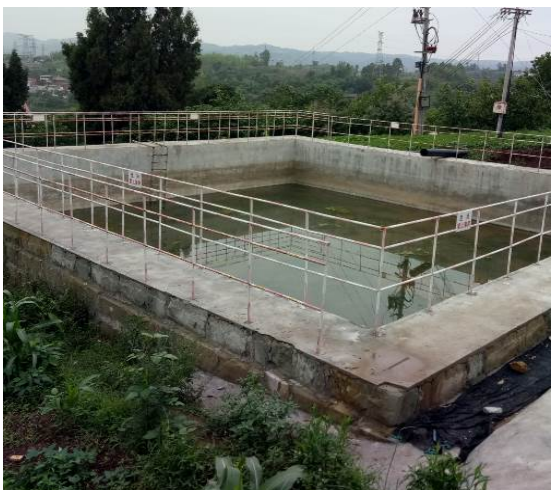
应急池 (挖损损毁程度: 重度)
