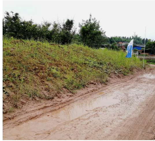
进场道路 (挖损损毁程度: 重度)
