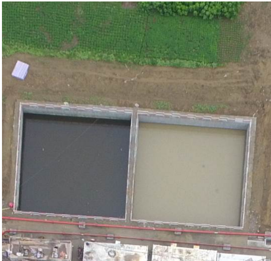
应急池 (挖损损毁程度：重度)
